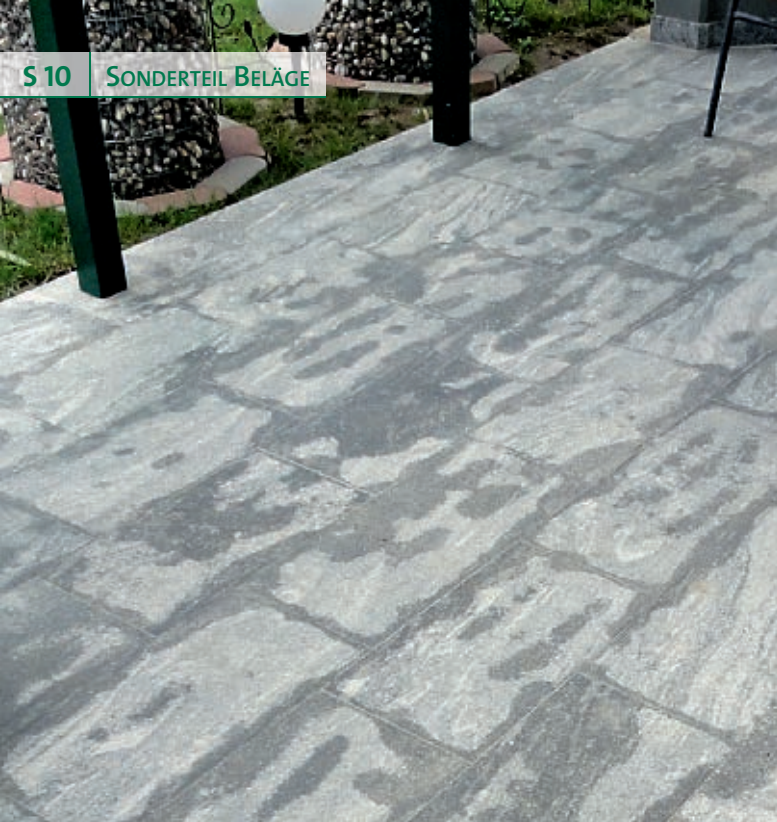
Die Terrassenplatten ohne rückseitige Beschichtung zeigen deutlich Feuchtigkeitsflecken. Fotos (4): Akemi
