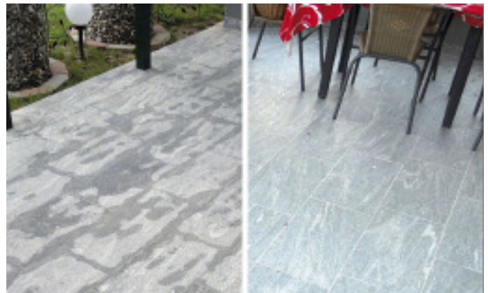
Links Verlegeergebnis ohne rückseitige Beschichtung (Flecken), rechts der erneuerte Belag mit rückseitiger Beschichtung (keine Flecken) Fotos: Akemi
