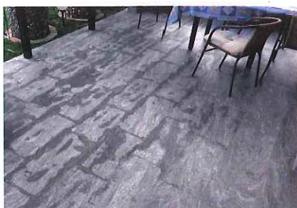
Terrassenbelag aus Naturwerkstein ohne Schutz
